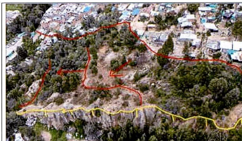
Foto 33. Escarpe minero que bordea una zona de antigua escombrera
