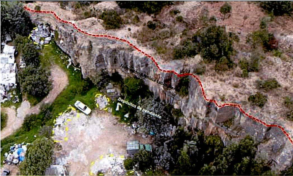
Foto 18. Depósitos de Pendiente (Qdp) en la base de los escarpes dejados por las antiguas explotaciones (color rojo). Se observan los botaderos sin compactación (color amarillo). Los taludes pueden alcanzar hasta más de 20 m de altura y están conformados por rocas de la Formación Arenisca Labor – Tierna.
