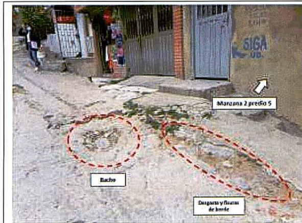
Foto 6. Carrera 164 b. Deterioro en el pavimento
