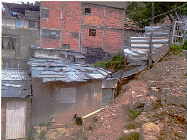
Fotografía 7. Vista de la vivienda V12, recomendada a evacuación mediante el DI-15916. Actualmente se encuentra habitada y presenta condiciones semejantes a las manifestadas en el DI-15916.
