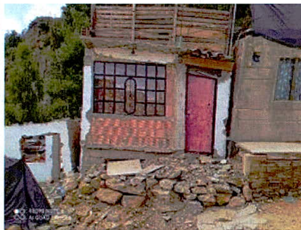
Fotografía 14. Vista de las viviendas V16 y V17 ubicadas en la zona media de la ladera inspeccionada (Fotografía tomada del DI-15916).
