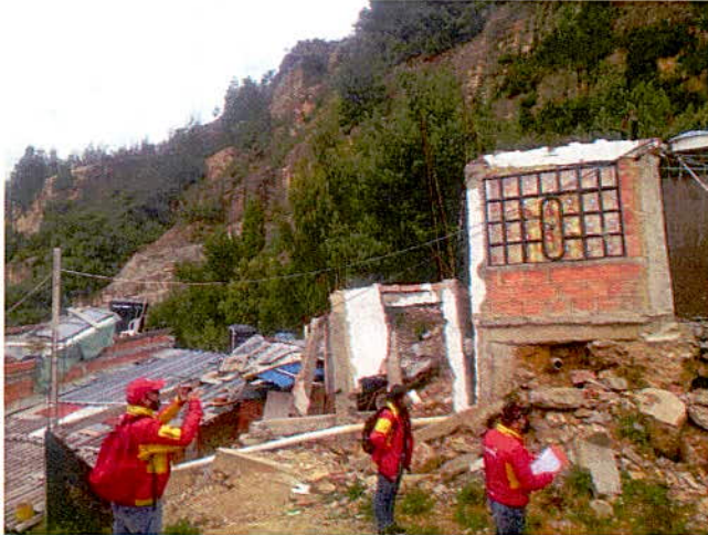
Fotografía 15. Vista de la vivienda V18, ubicada en la zona media de la ladera inspeccionada, en donde se observa que el suelo donde se emplazan continúa desplazándose.
