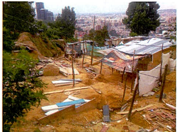
Fotografía 18. Vista de la zona alta de la ladera en el polígono inspeccionado en donde se observan múltiples ocupaciones, la construcción de nuevas ocupaciones y la adecuación del terreno para futuras ocupaciones.
