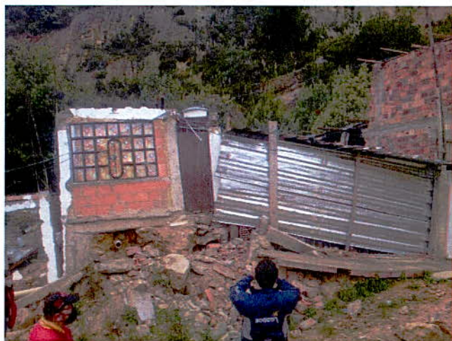
Fotografía 13. Vista de las viviendas V16 y V17, ubicadas en la zona media de la ladera inspeccionada, en donde se observa que el suelo donde se emplazan continúa desplazándose.
