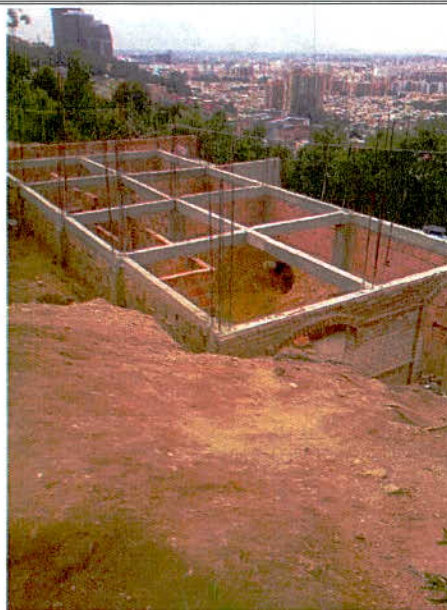
Fotografía 12. Vista de construcciones que se vienen adelantando en la zona media de la ladera del polígono inspeccionado.
