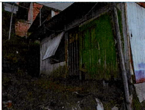
Fotografía 10. Fragilidad y deficiencias constructivas de las viviendas construidas en el sector.
