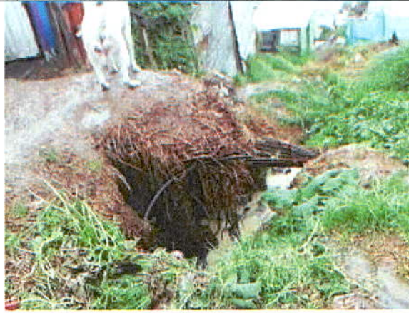
Fotografía 8. Carencia de redes para la disposición de aguas servidas. (A través de zanjás sobre el terreno) Calle 71 B Sur
