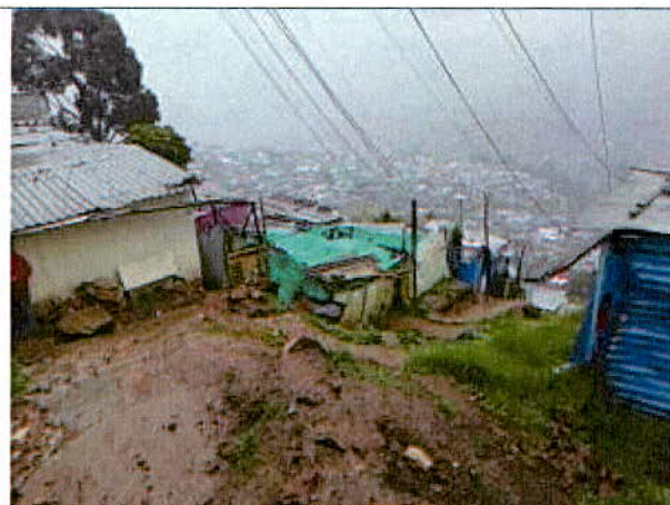
Fotografía 9. Ausencia de medidas de drenaje para la disposición del agua de escorrentía.
