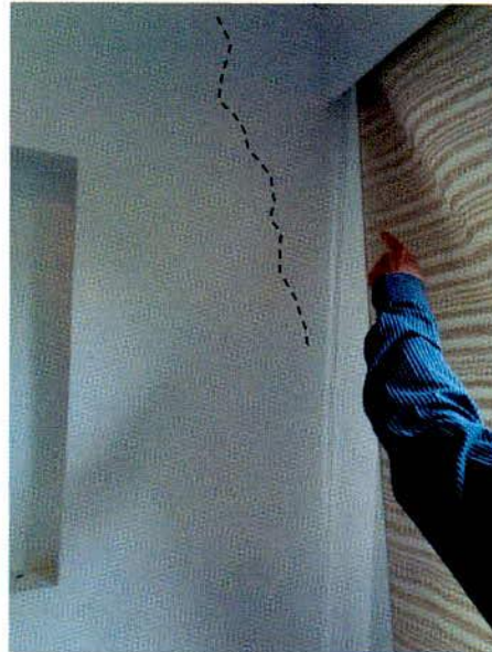
Fotografía 5 Fisuras en muros divisorios del Interior 1 del predio de la Calle 142 No 11-34.
