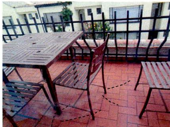
Fotografía 6. Fisuras en el acabado de la terraza en el Interior 1 del predio de la Calle 142 No 11-34.
