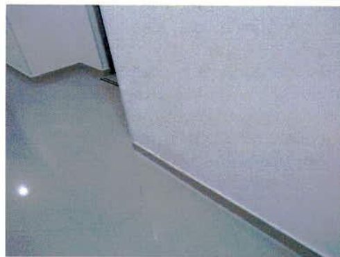
Foto 6. Humedad en los muros del corredor.
