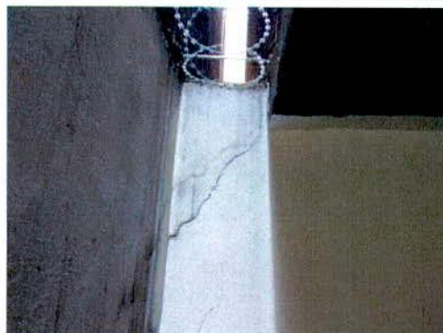
Foto 8. Fisuras diagonales en muros de parqueaderos del primer piso.
