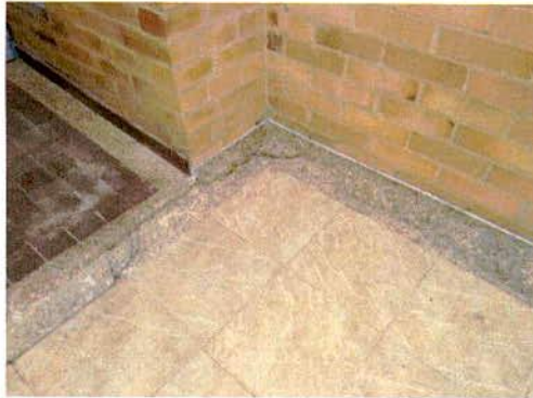
Foto 3. Fisuras en guarda escoba de terraza
