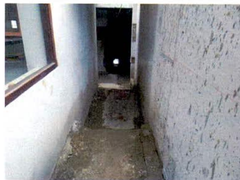
Foto 5. Estado actual de la vivienda de la Carrera 7 Este # 1 A - 32, en el área cercana al muro con filtraciones.
