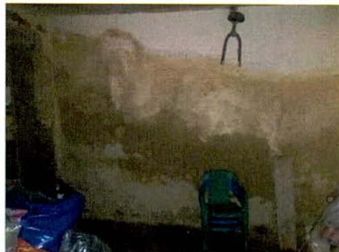
Foto 4. Presencia de humedad en el muro del predio de la Carrera 7 Este # 1 A - 36
