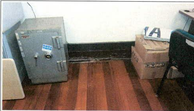
Fotos 9. Vista de los daños que se presentan en la edificación donde funciona la Dirección Local de Educación y la oficina de prensa.
