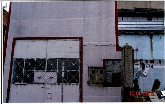
Foto No. 6. Muro con riesgo de colapso costado noroccidental
