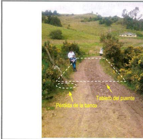
Fotografía 3. Vista del tablero del puente inspeccionado sobre el río Mugroso, que conduce a las veredas El Hato, Los Andes y La Unión en la Localidad Usme.
