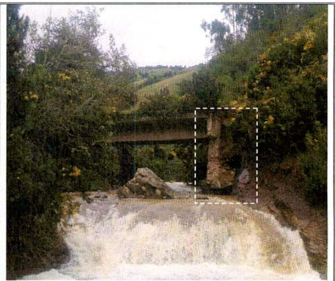
Fotografía 2. Vista del puente inspeccionado sobre el río Mugroso, que conduce a las veredas El Hato, Los Andes y La Unión en la Localidad Usme. Se observa la zona afectada del estribo de la margen izquierda del río.
