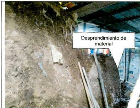
Fotografía 3. Vista de movimiento en masa al interior del predio visitado.
