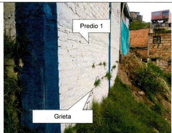
Fotografía 4. Vista de muro (costado occidental), se observan grietas y deformación.
