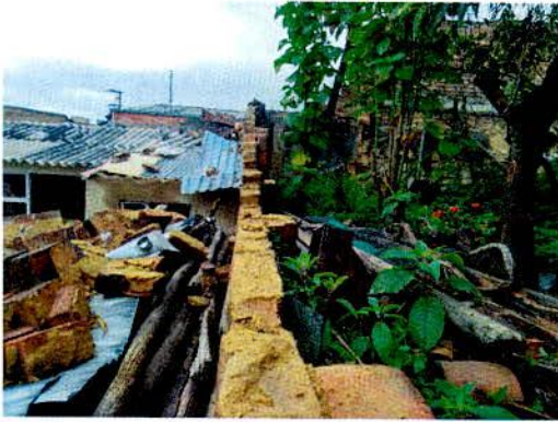
Foto 3. Colapso de muro de lindero
