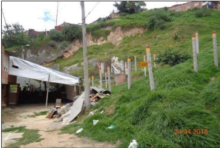
Ilustración 3-12 Vista general de la área afectada, predios reasentados y talud expuesto. Vista inferior
