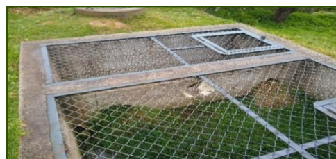
Ilustración 2-47 Desarenador obra de bioingenieria
