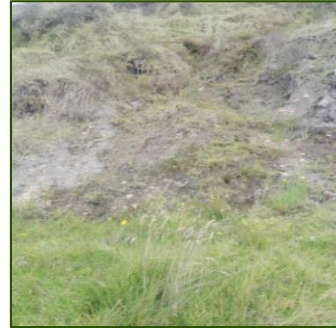
Ilustración 2-79 Taludes y procesos erosivos asociados a reasentamiento de viviendas
