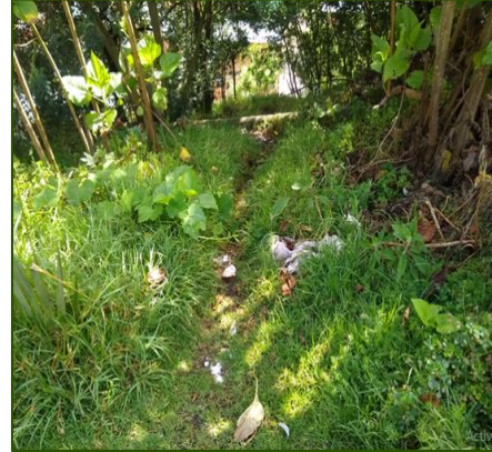
Ilustración 3-94 Surco de entrada de agua al escarpe principal
