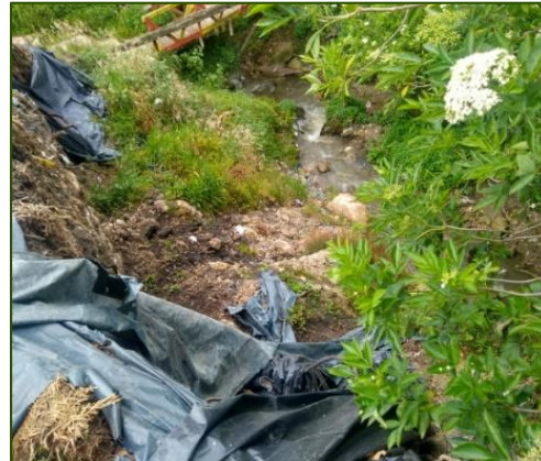
Ilustración 3-69 Estado de la pata del talud
