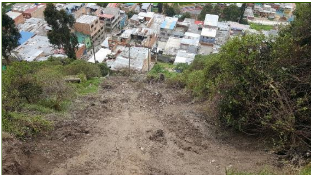
Ilustración 3-141 Vista superior del proceso generada por la entrada de agua al talud oriental
