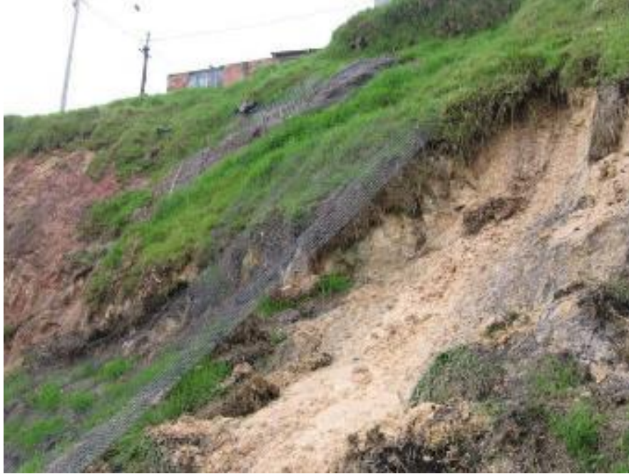
Ilustración 3-5 Detalle de las afectaciones en la geomalla principalmente. (Evento 65683)
