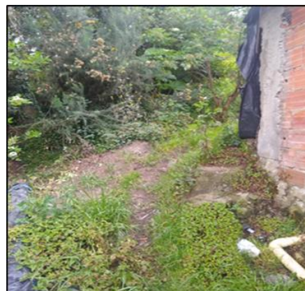
Ilustración 3-71 Proceso de socavación
