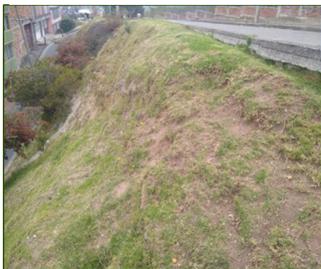
Ilustración 3-115 Vista superior proceso erosivo
