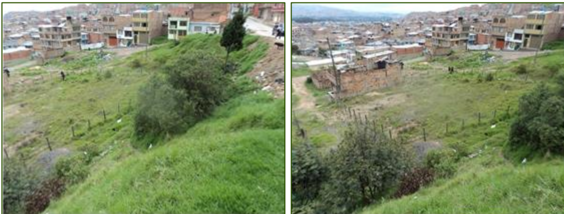
Ilustración 3-76 Se observa el poste de energía que podría resultar afectado, de presentarse un avance del proceso evidenciado. Adicionalmente, se observa la afectación sobre el andén del costado occidental de la carrera 4 Este.
