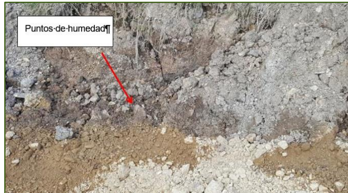
Ilustración 2-10 Puntos de humedad identificados
