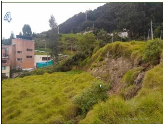
Ilustración 3-162 Escarpe principal del costado oriental
