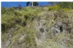
Presencia de humedad
