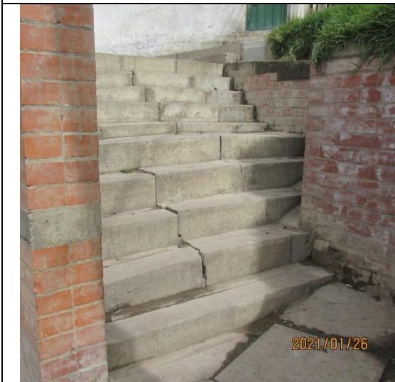
Fotografía 7 – Deformación de las escaleras de espacio público en el trasdós del muro de contención.
