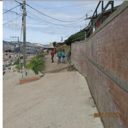
Fotografía 6 – Vista hacia el occidente del área de estudio, se aprecia afloramiento de agua en la base del muro de contención y el talud en relleno al fondo de la fotografía.
