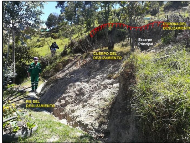
Fotografía 16. Deslizamiento rotacional costado este de la zona de estudio, involucrando materiales de relleno Fuente: consorcio Himec – Consulcons, 2018
