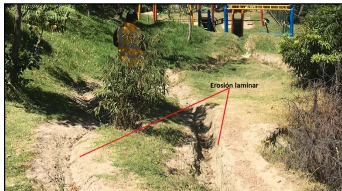
Fotografía 13. Procesos erosivos laminares sobre el relleno antrópico, costado este del parque infantil.
