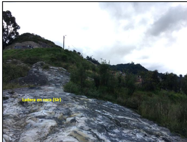
Fotografía 8. . Ladera en roca localizada sobre la parte alta y costado sur del Parque Barrio El Porvenir Fuente: consorcio Himec – Consulcons, 2018
