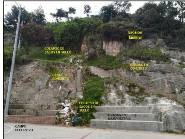
Fotografía 15. Caída de detritos, colapso de estructuras y erosión laminar, sobre la cara del talud en estudio. Fuente: consorcio Himec – Consulcons, 2018
