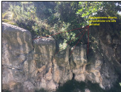
Fotografía 6. Talud de roca arenisca intensamente fracturado correspondiente a la Formación Regadera, costado sur del Parque Barrio El Porvenir. Fuente: consorcio Himec – Consulcons, 2018
