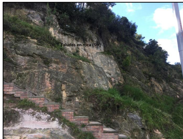
Fotografía 9. Taludes en roca arenisca localizados sobre el costado sur del Parque Barrio El Porvenir. Fuente: consorcio Himec – Consulcons, 2018
