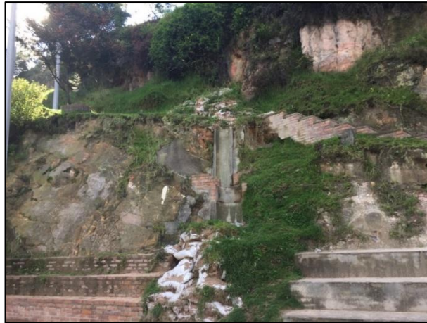
Fotografía 18. Caída de detritos, colapso de estructuras y erosión laminar, sobre la cara del talud en estudio.
