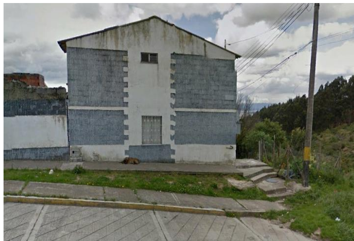
FOTO 7.7 INDICIOS DEL FLUJO DE TIERRAS FT-001IR: SE DESTACAN LA ABERTURA EN EL MURO DEL PATIO Y EL DESPLOME DEL POSTE DE ALUMBRADO
