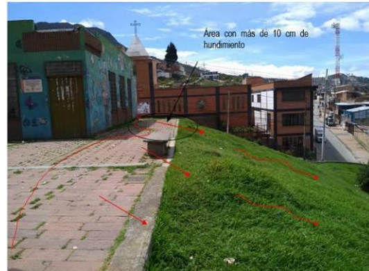
FOTO 7.14 PATRONES DE TRASLOCACIÓN EN EL FLANCO SUR DEL PARQUE. LOS HUNDIMIENTOS DE HASTA 10 CM Y LAS DEFORMACIONES EN EL ADOQUÍN CALCAN LA CORONA DE DESLIZAMIENTO.
