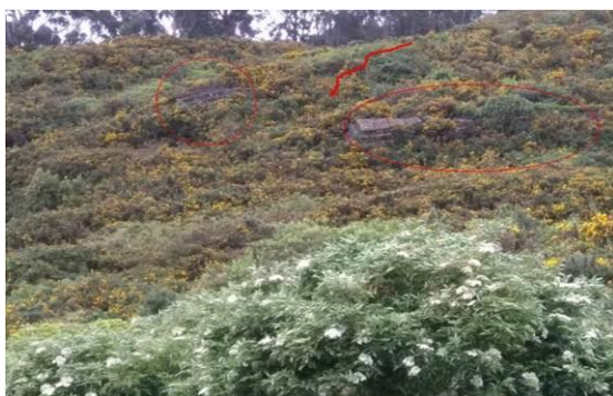
FOTO 7.3 MUROS DE GAVIONES FALLADOS EN LA PARTE BAJA DEL FLUJO DE TIERRAS SECUNDARIO. LAS DOS ESTRUCTURAS YACEN DESPLAZADAS Y BASCULADAS EN SENTIDO HORARIO, REFLEJO DE UNA PROFUNDA SUPERFICIE DE DESLIZAMIENTO.
