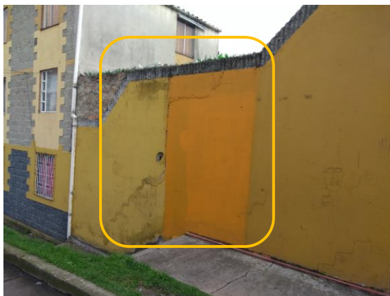
FOTO 8.5 AGRIETAMIENTO DE MUROS
