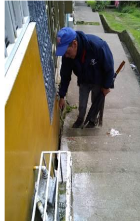
FOTO 7.9 DISTORSIONES ENTRE EL ANDÉN Y LAS EDIFICACIONES: LA ABERTURA ALCANZA LOS 0.05 M
