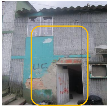
FOTO 8.3 PREDIOS CON DETERIORO EN FACHADAS Y POSIBLES DAÑOS ESTRUCTURALES
