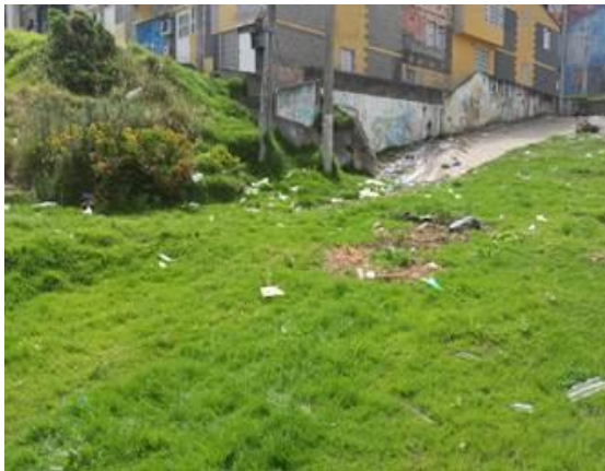
FOTO 6.3 LLORADEROS EN LA CR 17 ESTE CON CL 41 SUR: EL CINTURÓN VERDE OPERA HÚMEDO PRODUCTO DE LAS DESCARGAS DE ESCORRENTÍA DE LA CALLE Y DE LA LADERA.
