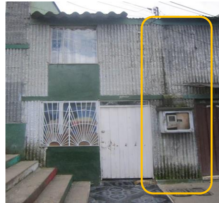
FOTO 8.2 PROBLEMAS DE HUMEDAD EN LAS VIVIENDAS
