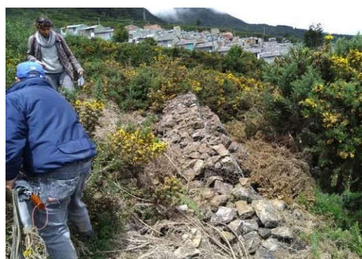
FOTO 7.2 EVIDENCIAS DE ACTIVIDAD EN EL DESLIZAMIENTO: VOLCAMIENTO DEL MURO DE GAVIONES CIMENTADO EN LA PARTE ALTA
