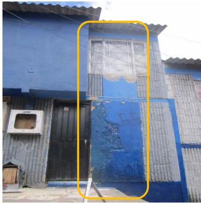
FOTO 8.1 DAÑOS EN FACHADA DE VIVIENDAS, DETERIORO DE LA ESTRUCTURA
