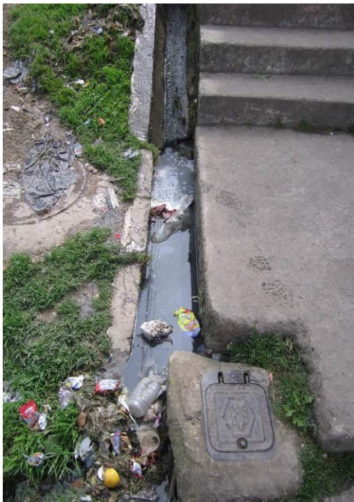
FOTO 6.1 CUNETAS OBSTRUIDAS CON BASURA EN LA ESQUINA SUROCCIDENTE DEL PREDIO 31 DE LA MANZANA 64
