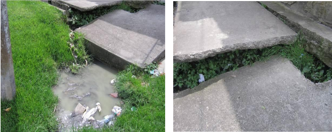
FOTO 6.5 ROMPIMIENTO DE LA PLACA DEL ANDEN EN LA ESQUINA NOROCCIDENTE DEL PREDIO 32 DE LA MANZANA 63
