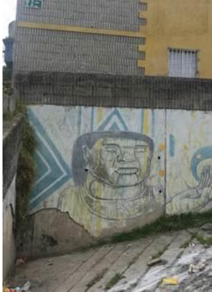
FOTO 6.2 LLORADEROS SECOS O INOPERANTES EN LA CR 17 ESTE CON CL 41 SUR
