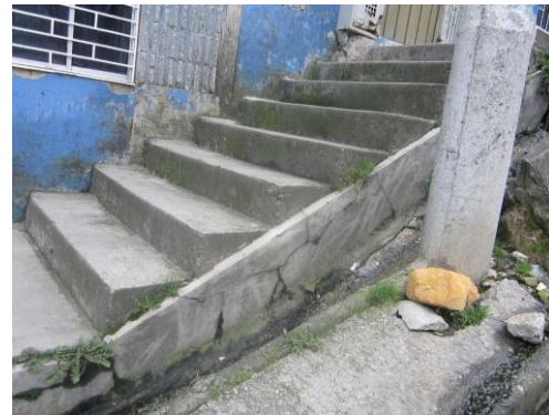
FOTO 8.4 DETERIORO DE SENDEROS PEATONALES
