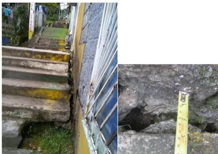
FOTO 7.6 SEPARACIÓN ENTRE EL ANDÉN Y LA EDIFICACIÓN DE HASTA 10 CM, EVIDENCIA DEL DESPLAZAMIENTO LENTO DE LA LADERA
