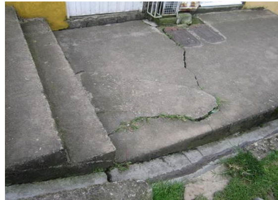
FOTO 7.11 RUPTURA DEL ANDÉN INCUBADA POR EL FLUJO LENTO DEL CUATERNARIO: TOMA LUGAR EN LA ESQUINA NORORIENTAL DEL PREDIO 62 DE LA MANZANA 78.
