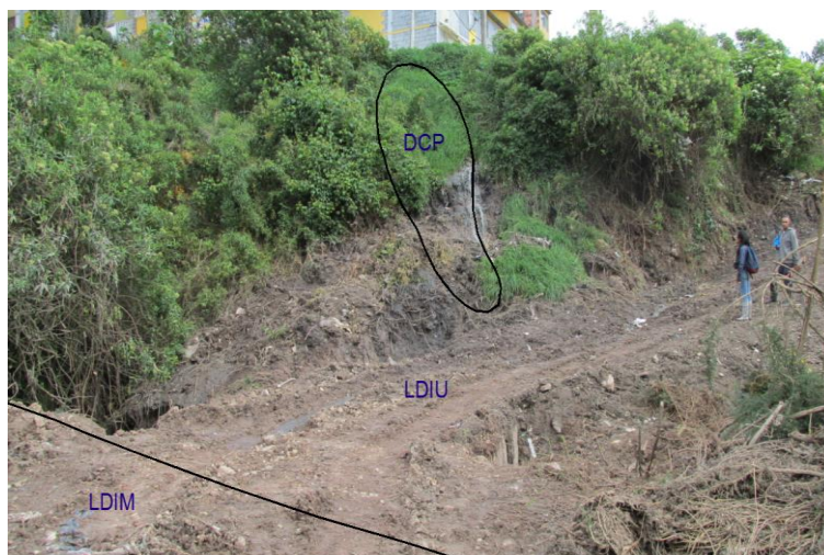
FOTO 3.9 CONO DE DESLIZAMIENTO EN LA ESQUINA NOROESTE DE LA MANZANA 78
