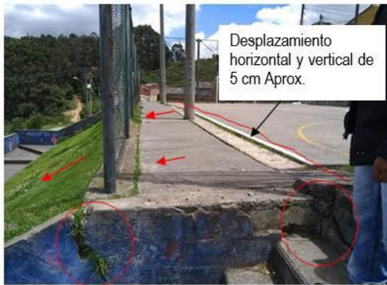
FOTO 7.13 TRAZAS DE ACTIVIDAD DEL DESLIZAMIENTO Dt004AA: LAS GRIETAS POSEEN 0.05 M DE ABERTURA Y SURCAN DE NORTE A SUR
