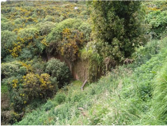
FOTO 7.8 DEFORMACIONES EN LAS SUPERFICIES LIBRES Y EN LOS CUERPOS DE LOS RELLENOS DE LA MARGEN SUR DE LA QUEBRADA, PROMOVIDAS POR EL FOCO DE INESTABILIDAD.
