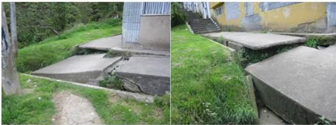
FOTO 7.12 ESQUINA NOROCCIDENTAL DE LA MANZANA 78, ES EL ESPACIO QUE ENCIERRA LAS MÁS CLARAS HUELLAS DE ACTIVIDAD DEL PROCESO DP-003. LA RUPTURA Y EL DESPLOME DEL ANDÉN Y LAS DEFORMACIONES DE LA MASA DE SUELO SON ALGUNAS DE ELLAS.
