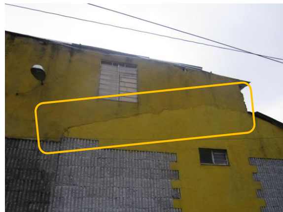
FOTO 8.6 AGRIETAMIENTO EN MUROS PARTE DE LA ESTRUCTURA DE LA VIVIENDA
