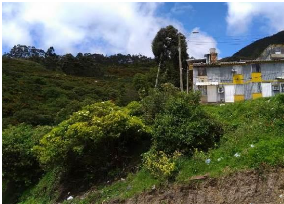
FOTO 7.10 LADERA NOROCCIDENTAL DE LA MANZANA 78: ESTÁ SOMETIDA A ABUNDANTES DESCARGAS RESIDUALES, QUE HAN PROVOCADO EL BASCULAMIENTO DE LOS POSTES DE ENERGÍA.
