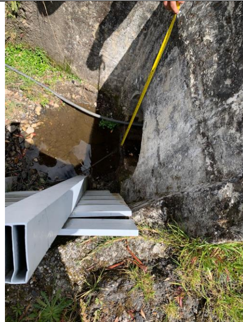
Fotografía 7. Descole insuficiente para la entrega de aguas recogidas por esta obra
