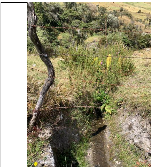
Fotografía 10. No se cuenta con un descole apropiado, por lo cual las aguas recogidas por esta alcantarilla se vierten al terreno natural
