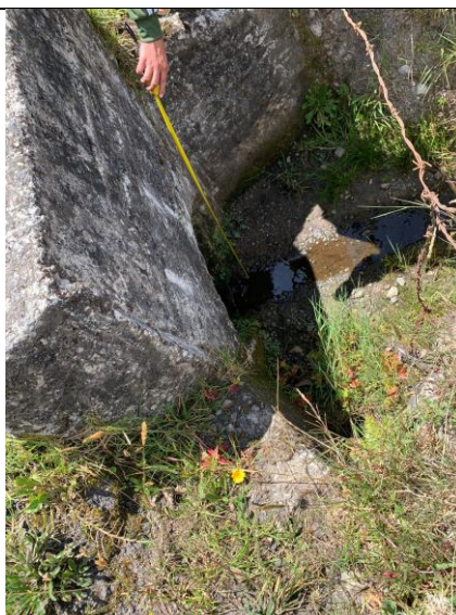
Fotografía 11. En la salida de agua de alcantarillado se evidencian aletas.
