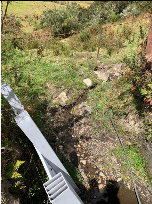
Fotografía 6. No se cuenta con un descole apropiado, por lo cual las aguas recogidas por esta alcantarilla se vierten al terreno natural
