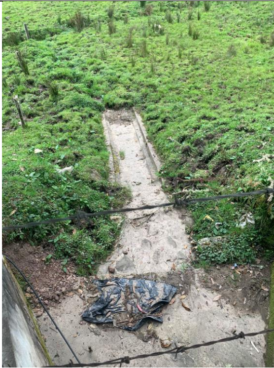
Fotografía 9. Existe descole, sin embargo, este es insuficiente puesto que se vierten las aguas recolectadas al terreno natural
