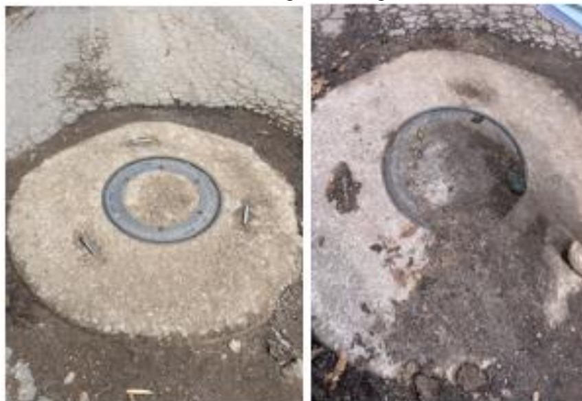
Fotografía 14. red de Alcantarillado, nodo Santa Ana Fuente Geodinámica
