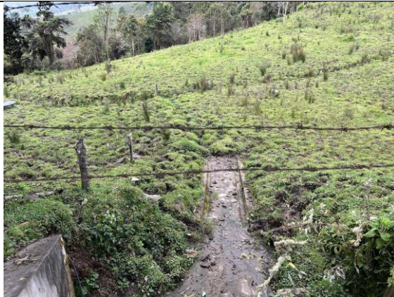
Fotografía 20 Deficiencia en el descole de las alcantarillas encontradas a lo largo del nodo.
