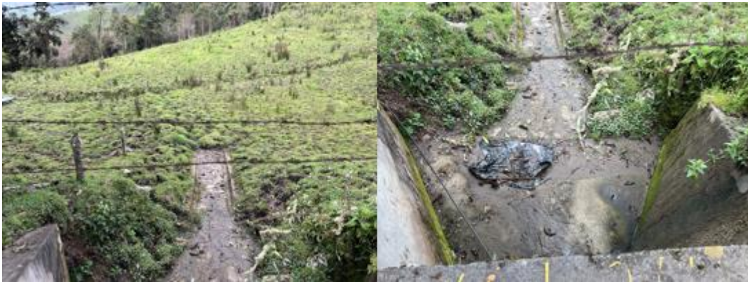
Fotografía 15. Alcantarillas presentes en el nodo Santa Ana Fuente: Geodinámica
