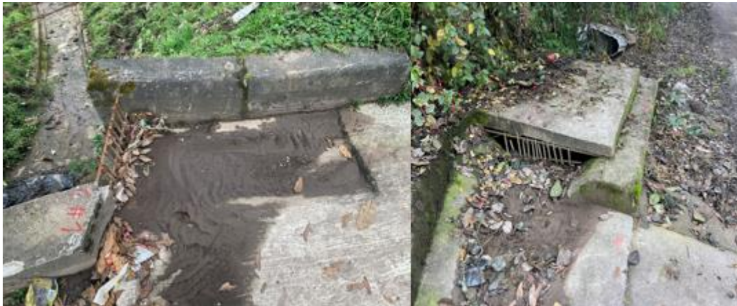
Fotografía 16. Obstrucción de alcantarilla por basura y sedimentos Fuente. Geodinámica
