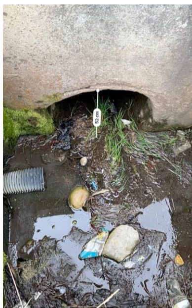
Fotografía 22. Alcantarilla de 24" con obstaculización por basuras y sedimentos
