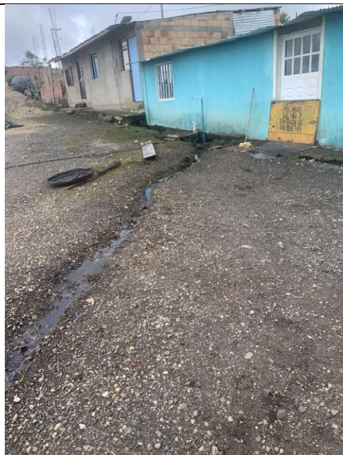
Fotografía 25. Mal manejo de aguas residuales y lluvias.
