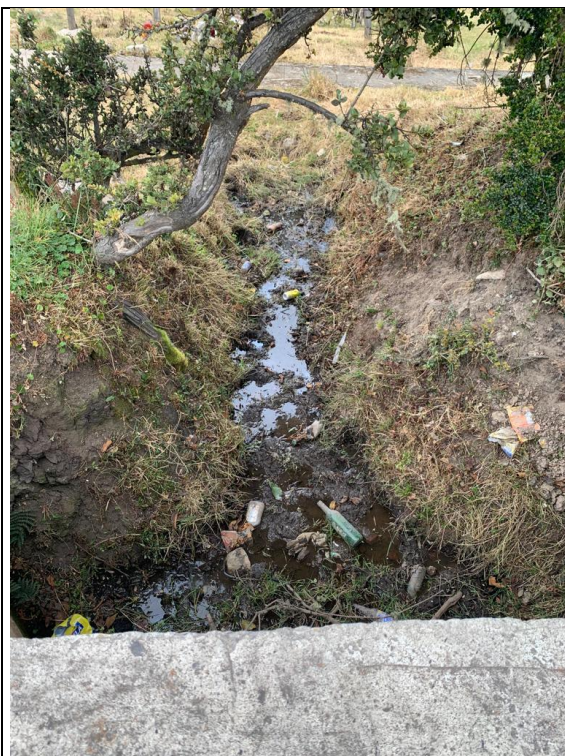
Fotografía 14. No se cuenta con un descole apropiado, por lo cual las aguas recogidas por esta alcantarilla se vierten al terreno natural
