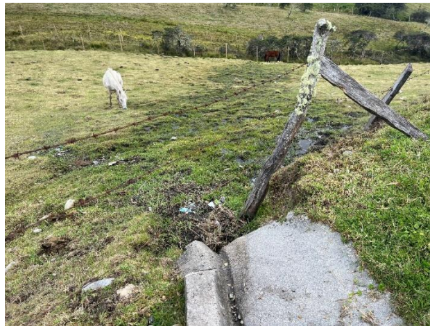
Fotografía 17. Encharcamiento por mal manejo de aguas. nodo Tunal Alto Fuente: Geodinámica
