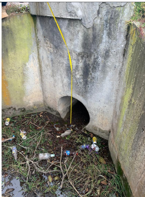
Fotografía 15. Se evidencia la presencia de aletas
