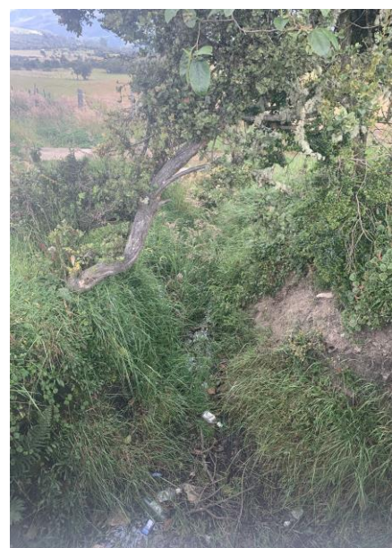
Fotografía 23. Las alcantarillas presentan descole deficiente
