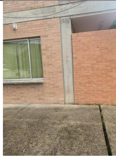
Fotografía 24 Edificio de profesores, que presenta problemas de agrietamiento.
