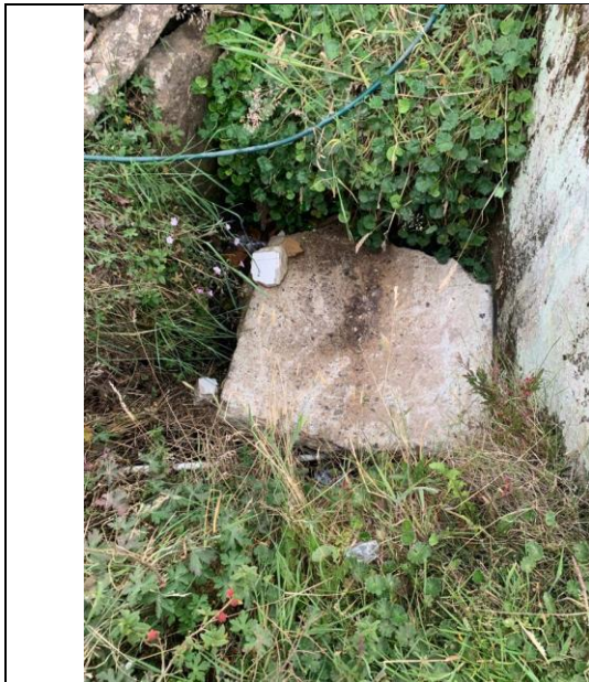
Fotografía 12. Se observa que la alcantarilla se encuentra taponada por una placa en concreto, de
