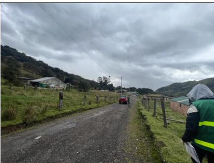
Fotografía 29 Zonas de infiltración presentadas a lo largo de la vía de acceso al colegio.
