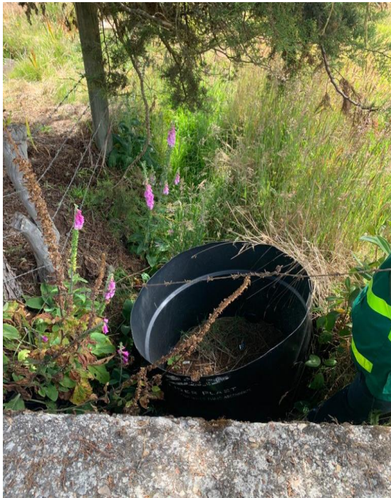
Fotografía 14. No se cuenta con un descole apropiado, por lo cual las aguas recogidas por esta alcantarilla se vierten al terreno natural
