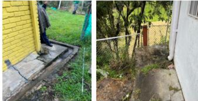
Fotografía 27. Estado actual de obras hidráulicas para la recolección de aguas lluvia, nodo el Raizal
