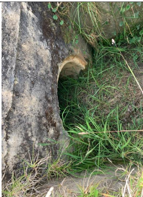
Fotografía 8. La alcantarilla está equipada con muro cabezal, Guarda ruedas y muro de solado
