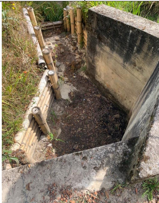
Fotografía 18. Se evidencia descole, pero se resalta que este no es eficiente ya que se vierten más adelante las aguas recogidas por esta alcantarilla al terreno natural
