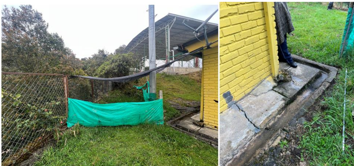
Fotografía 2. Problemática encontrada en el nodo de estudio.
