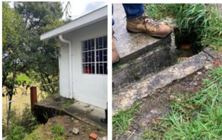
Fotografía 28. Tubería de 2" recolectora de aguas lluvias
