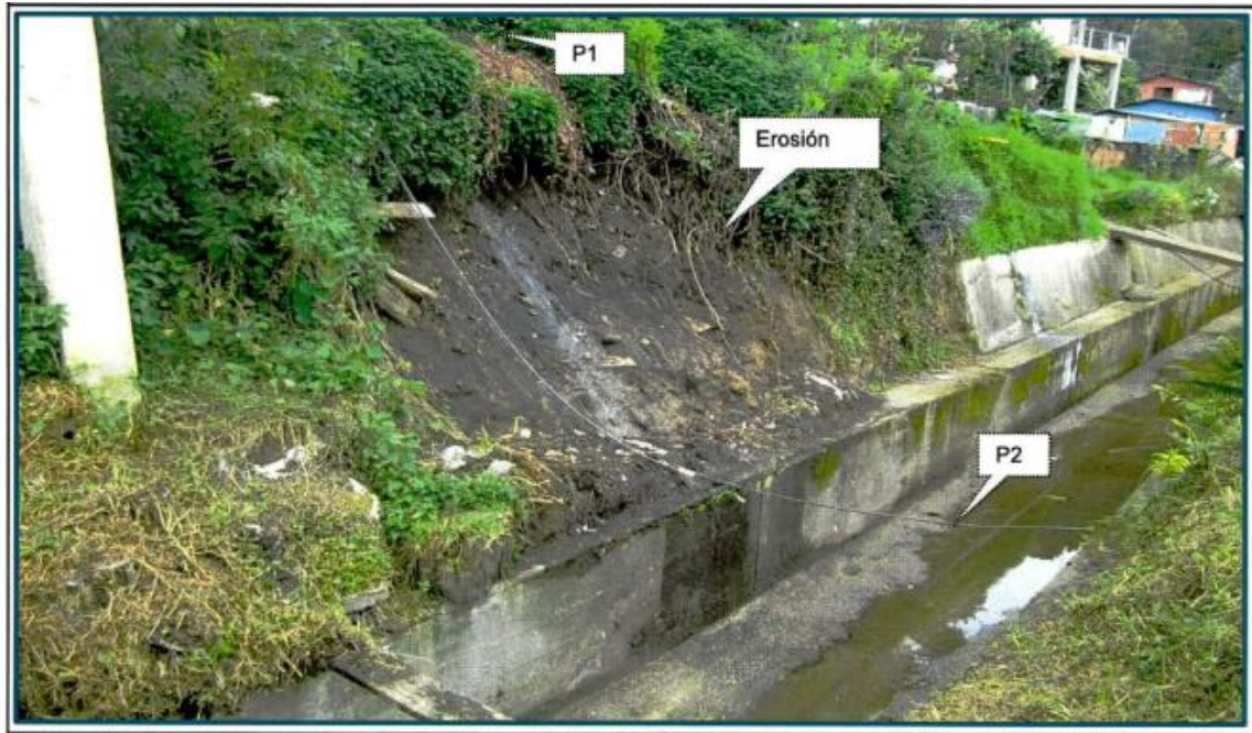
Figura 10. Fotografía asociada con el desprendimiento de materiales superficiales en el talud del costado oriental al interceptor de aguas lluvias de la Empresa de Acueducto de Bogotá, TV 7 Este No. 58 A 49. DI-10721. Mayo de 2017. IDIGER (2017)
