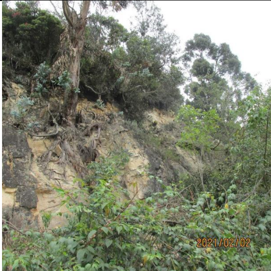
Fotografía 4 – Talud en roca con evidencias de meteorización y caída de bloques.
