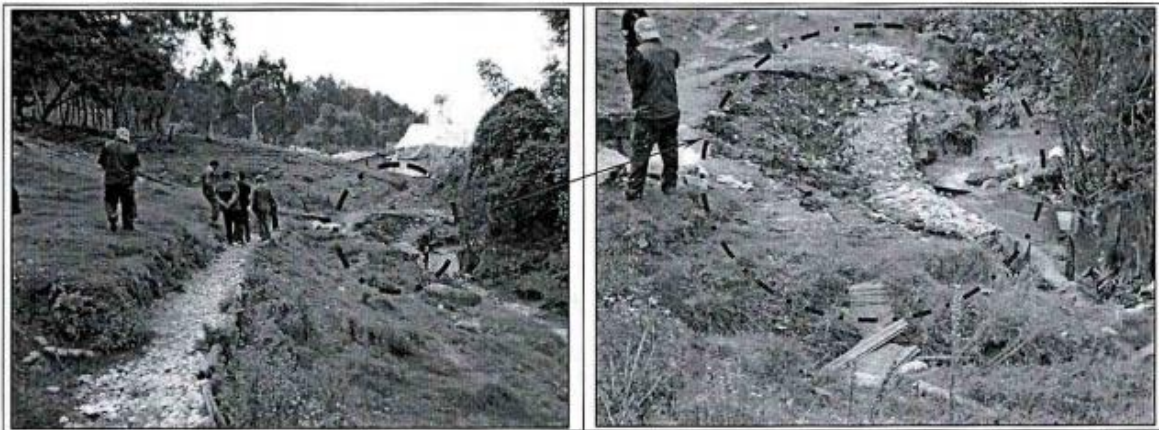
Figura 5. Vista de la margen izquierda de la quebrada las Delicias, donde se implementó como medida de estabilización un gavión, el cual al momento de la inspección visual presenta falla, identificada por la pérdida de verticalidad del mismo hacia la quebrada Las Delicias. Fotografías asociadas falla de muro de gaviones en el cauce de la Quebrada Las Delicias. DI-6711. Octubre 19 de 2012. FOPAE (2012)
