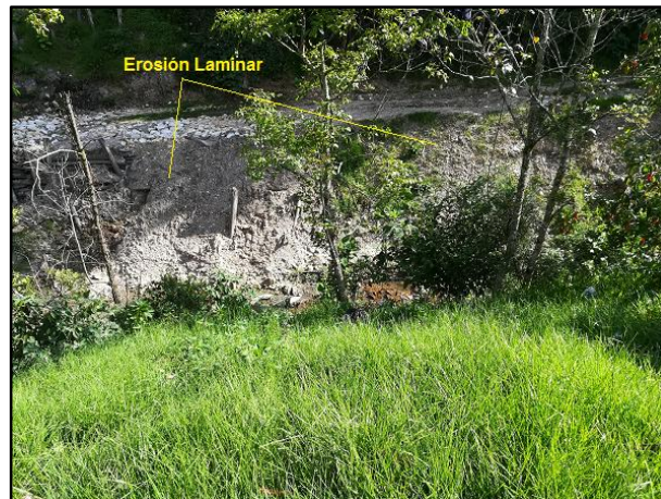
Fotografía 15. Procesos de erosión laminar sobre relleno heterogéneo presente hacia la margen derecha del Rio Arzobispo. Fuente: Consorcio Himec – Consulcons, 2018
