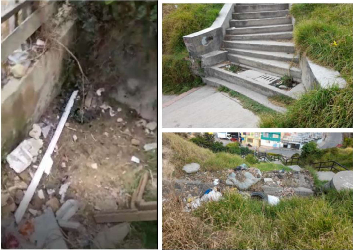
Figura 64 Estado de colmatación de la caja, sumidero y canal en la corona
