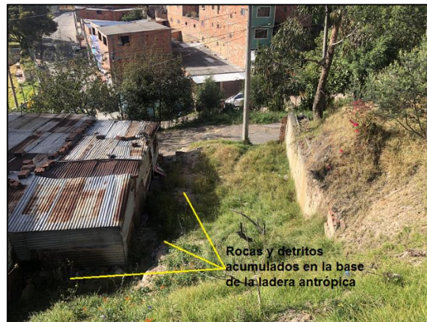
Fotografía 12 Rocas y detritos acumulados en la parte posterior de una de las viviendas del sector a causa de los movimientos de caída ocurridos en la ladera antrópica.
