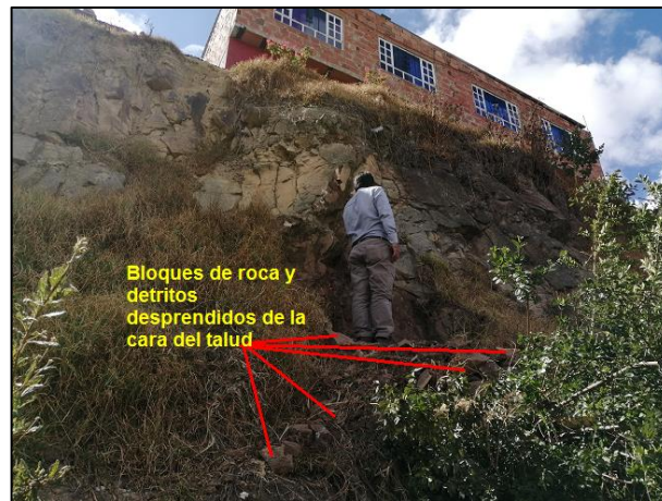
Fotografía 11 Caída de detritos ubicada en la base del talud rocoso aflorante en el área de estudio.
