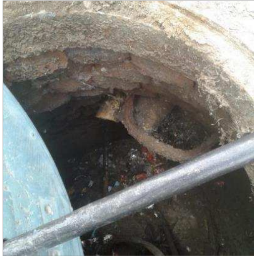
Ilustración 4-94 Acometidas irregulares a los pozos de inspección
