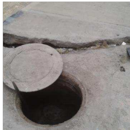
Ilustración 4-96 Ruptura de calzada sobre el colector
