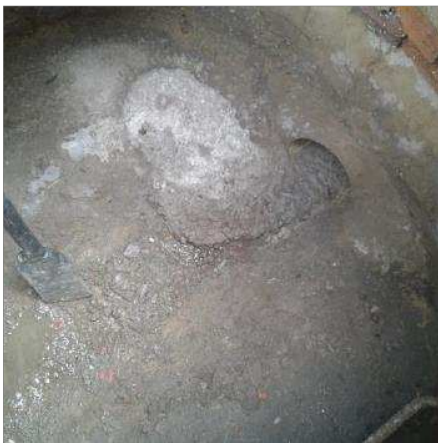
Ilustración 4-95 Taponamiento de colectores de aguas residuales
