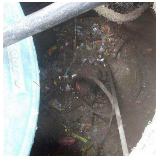
Ilustración 4-93 Pozo de inspección con residuos dispuestos por la comunidad
