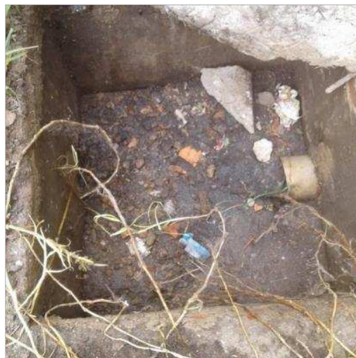
Ilustración 4-99 Conexiones domiciliarias con residuos y sedimentos
