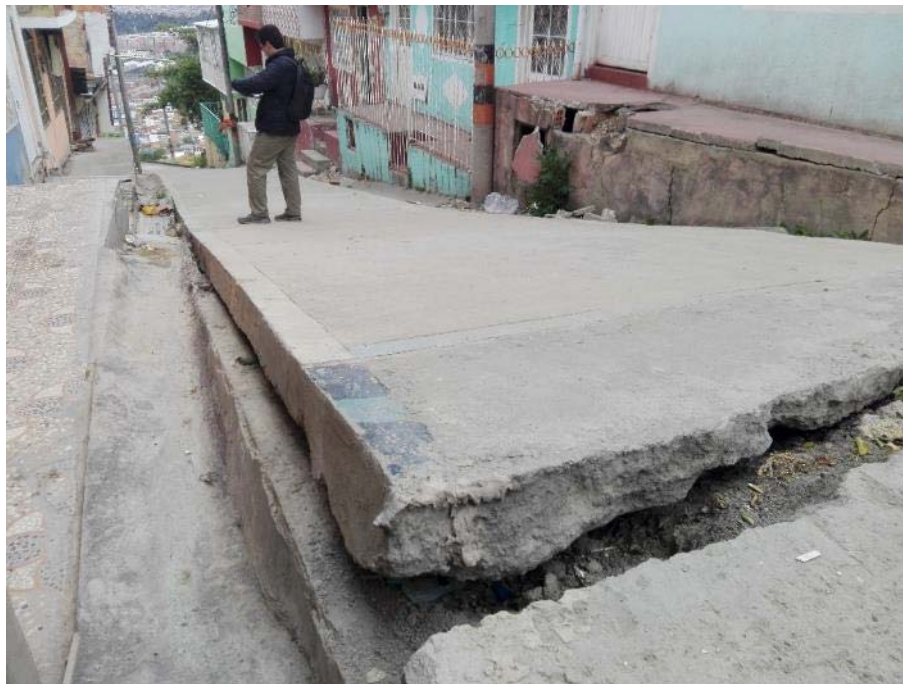
Ilustración 6-9 Daños sobre la infraestructura vial, rotura y deformaciones.
