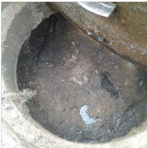
Ilustración 4-92 Pozo de inspección colmatado
