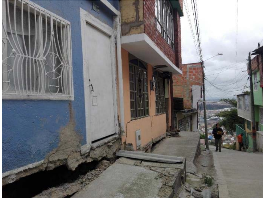
Ilustración 6-8 Daños sobre las edificaciones en la zona en condición de amenaza alta por movimientos en masa falla en roca, adelante las viviendas sobre la grieta (Colapso Parcial), al fondo viviendas en la zona de movimiento (Deformaciones e inclinaciones de la estructura).
