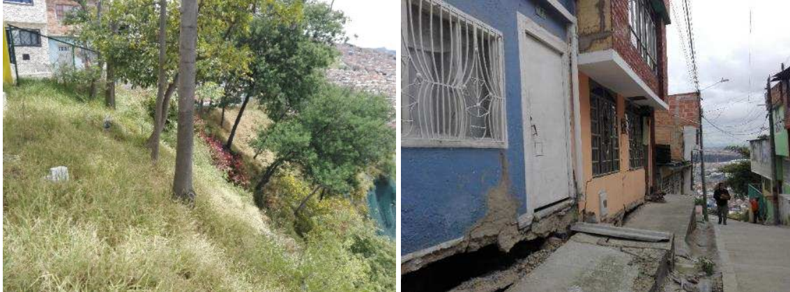
Ilustración 4-76 Aspecto zona 1, presenta viviendas notoriamente dañadas e inclinación de la vegetación.
