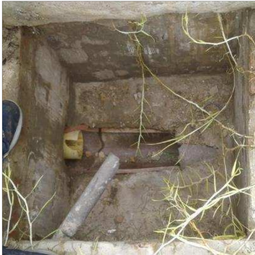
Ilustración 4-97 Tuberías sanitarias rotas
