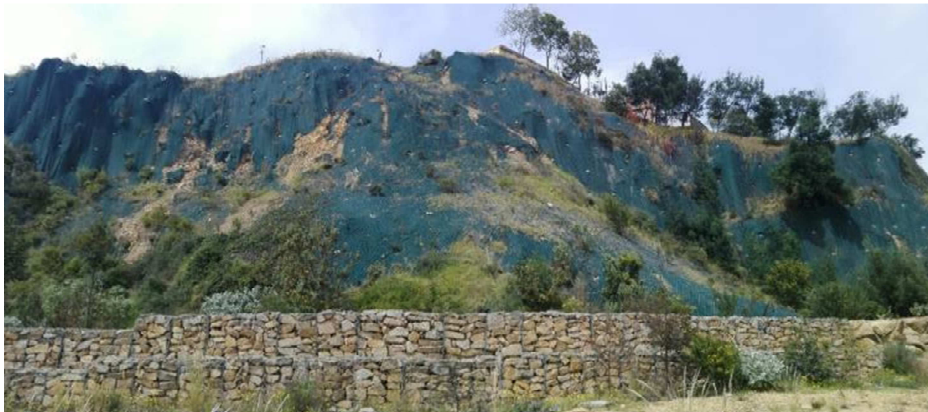
Ilustración 4-74 Aspecto zonas 1, con presencia de flujos de detritos
