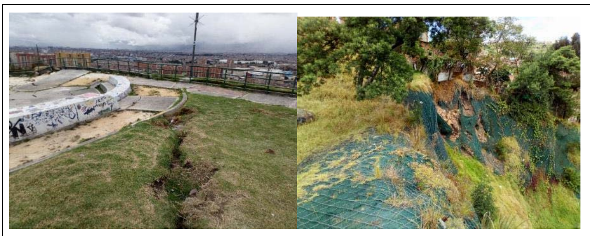
Ilustración 8-46 Deterioro de las coberturas biológicas producto del movimiento, desplazamiento de las especies vegetales.
