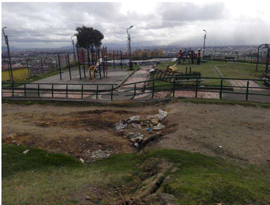
Ilustración 4-75 Aspecto parte superior de la zona I, donde se observa el escarpe del movimiento en masa profundo
