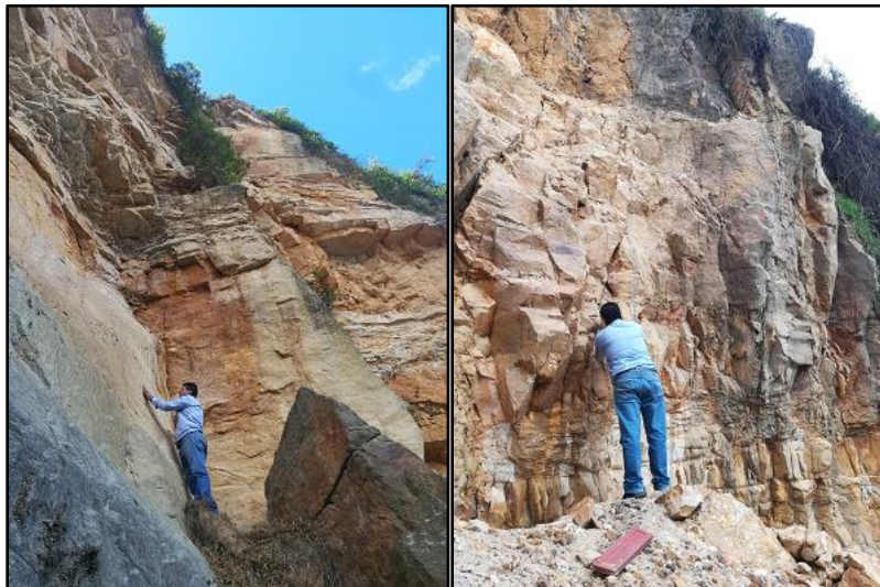
Fotografía 21. Levantamiento de discontinuidades del macizo rocoso, sobre la cara del talud 4 (Izquierda) y en talud 3 parte superior (Derecha).
