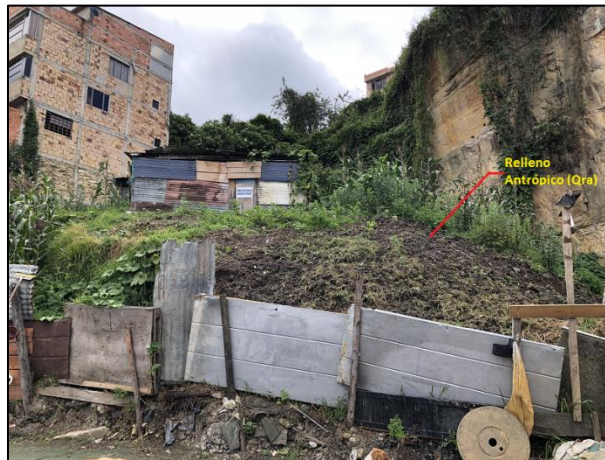
Fotografía 13. Afloramiento del Relleno Antrópico localizado en la base del talud al costado norte de la zona de estudio. Fuente: Consorcio Himec – Consulcons, 2018
