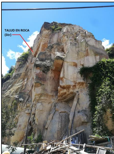
Fotografía 14. Geoforma de Talud rocoso localizado en el costado sur del área de interés, barrio El Codito – Localidad de Usaquén Fuente: Consorcio Himec – Consulcons, 2018
