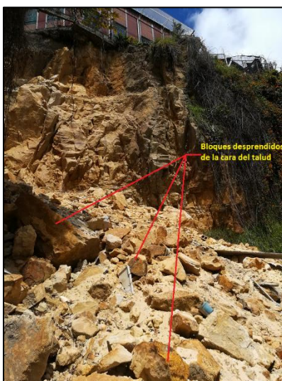
Fotografía 18. Caída de bloques de roca arenisca deleznable, localizada en la parte inferior del jardín CDI Estrellita de Oriente. Fuente: Consorcio Himec – Consulcons, 2018
