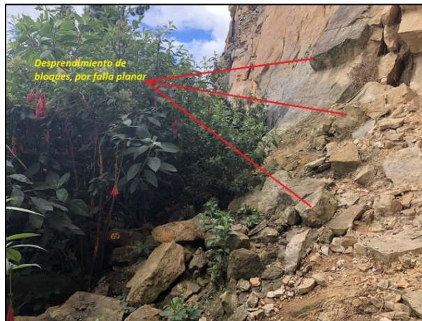
Fotografía 20. Desprendimiento de bloques de arenisca por mecanismo de falla plana sobre los taludes existentes. Fuente: Consorcio Himec – Consulcons, 2018
