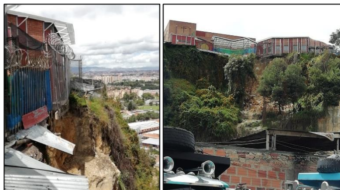
Fotografía 3. Zona afectada por deslizamiento(Izquierda) y Zona de deslizamiento.(Derecha)
