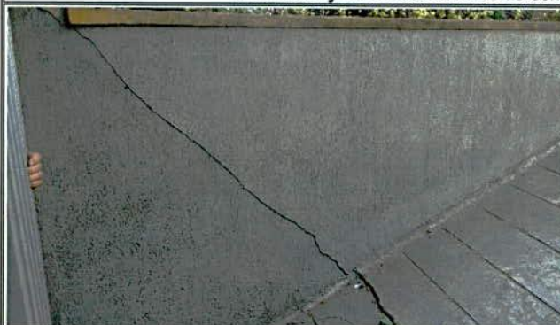
Foto No. 5. Grieta en muros de acceso al semisótano – Tomado de DI-10220 – 09/02/2017
