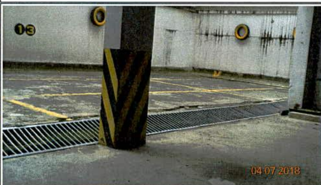
Foto No. 10. Hundimiento placa de contrapiso - 04/07/2018
