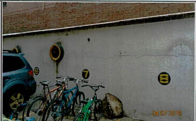
Foto No. 2. Grietas en muro de cerramiento perimetral sector del semisótano
