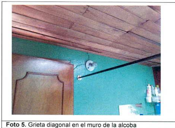
Foto 5. Grieta diagonal en el muro de la alcoba
