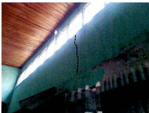
Foto 2. Grieta vertical en el muro de fachada
