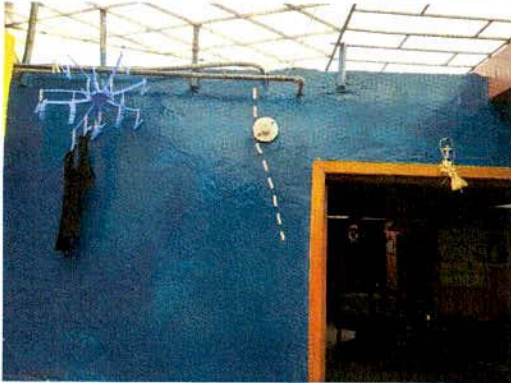
Foto 3. Grieta diagonal en el muro divisorio
