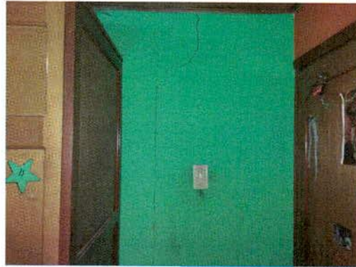
Foto 4. Grieta vertical y diagonal en los muros de la alcoba
