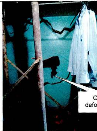
Fotografía 4. Vista de muro interior de vivienda en P1, contiguo a P3 en obra, se observan grietas y deformaciones generalizadas.
