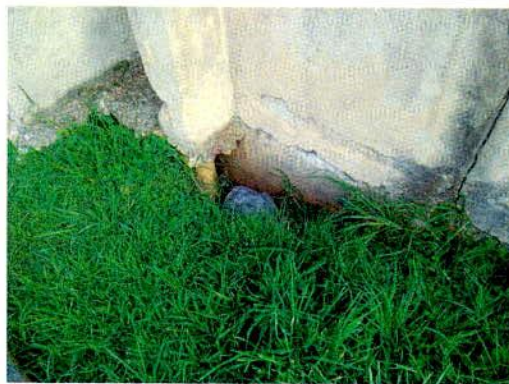
Foto 5. Socavación costado noroccidental
