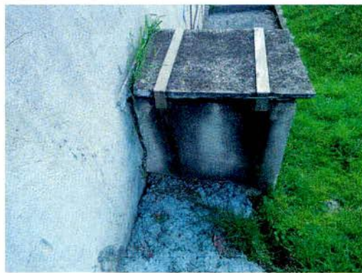
Foto 2. Desprendimiento de la caja de acometidas
