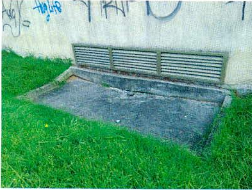
Foto 3. Hundimiento en las placas de concreto
