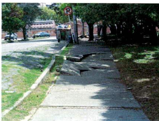
Fotografía 2. Losas de sendero peatonal quebradas
