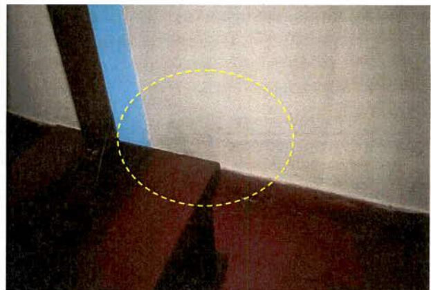
Fotografía 8. Humedad y deterioro de acabados en muros de cerramiento de algunas viviendas inspeccionadas y ubicadas a la altura de la Carrera 14 L entre la Calle 73 D Bis Sur y la Calle 74 B Sur.
