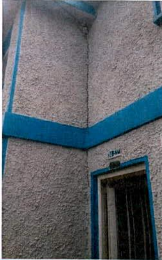
Fotografía 3. Fisuras y grietas identificadas en muros de cerramiento y divisorios del costado suroriental de la vivienda ubicada en el predio de la Carrera 11 B No. 34 – 51 Sur.
