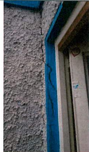
Fotografía 4. Fisuras y grietas identificadas en muros de cerramiento y divisorios del costado suroriental de la vivienda ubicada en el predio de la Carrera 11 B No. 34 – 51 Sur.
