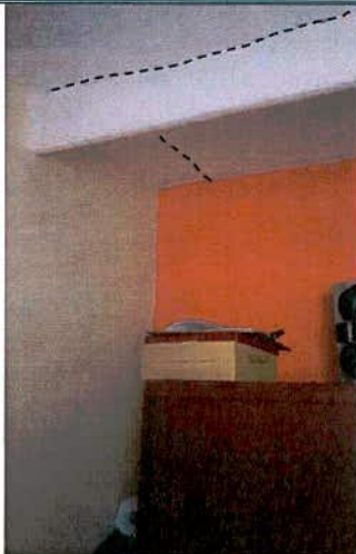
Fotografía 9. Separaciones entre vigertería y losetas de la placa de entrepiso del costado suroriental de la vivienda ubicada en el predio de la Carrera 11 B No. 34 – 51 Sur.
