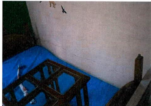
Fotografía 6. Fisuras y grietas identificadas en muros de cerramiento y divisorios del costado suroriental de la vivienda ubicada en el predio de la Carrera 11 B No. 34 – 51 Sur.
