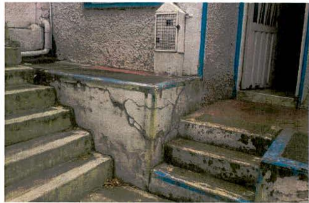
Fotografía 10. Fracturas en muros que conforman el andén de la zona de acceso a la vivienda localizada en el predio de la Carrera 11 B No. 34 – 51 Sur.
