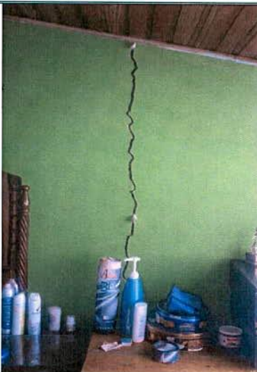
Fotografía 5. Fisuras y grietas identificadas en muros de cerramiento y divisorios del costado suroriental de la vivienda ubicada en el predio de la Carrera 11 B No. 34 – 51 Sur.
