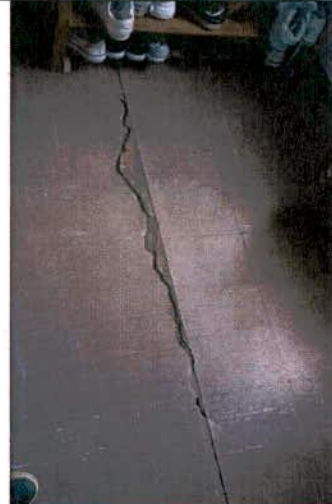
Fotografía 8. Separaciones entre vigertería y losetas de la placa de entrepiso del costado suroriental de la vivienda ubicada en el predio de la Carrera 11 B No. 34 – 51 Sur.
