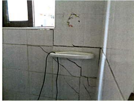
Fotografía 2. Fisuras del enchape al interior del baño de la portería del edificio Canoa I
