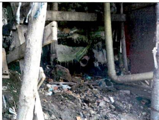
Fotografía 9. Entrega inadecuada de las aguas residuales directamente al terreno, carentes de un sistema de conducción que evite la infiltración de estas en el subsuelo.
