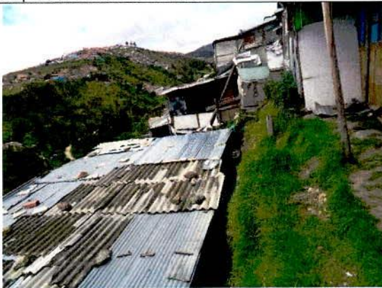
Fotografía 7. Implementación de cortes a media ladera para la adecuación de las viviendas, de alturas que superan 2 metros, sin sistemas de contención.
