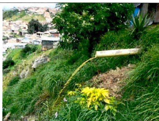
Fotografía 10. Las aguas residuales que se descargan a media ladera, las cuales fluyen sin control adecuado hacia la parte baja.
