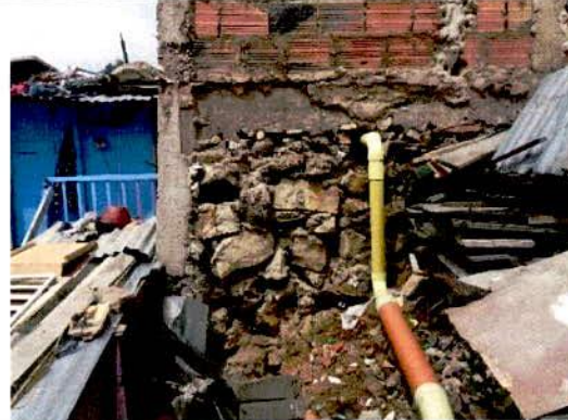
Fotografía 6. Algunas viviendas presentan cimentaciones de piedra pegada cimentadas de manera superficial sobre rellenos antrópicos.
