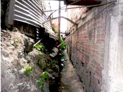
Fotografía 5. Se observa el corte y relleno en el terreno sin medidas de contención ni manejo de aguas adecuado para el emplazamiento de las viviendas.
