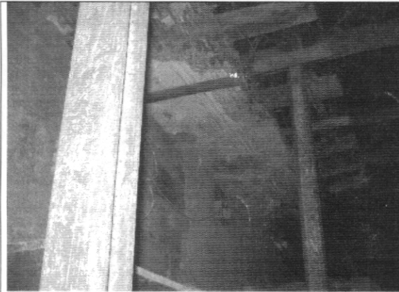
Foto 7. Deterioro estructura soporte cielo raso
