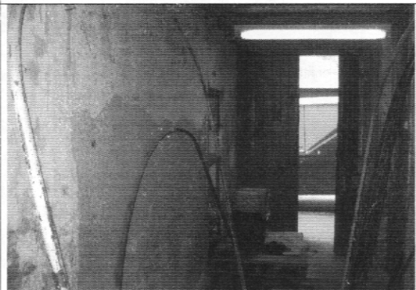
Foto 6. Deterioro de acabados en muros interiores
