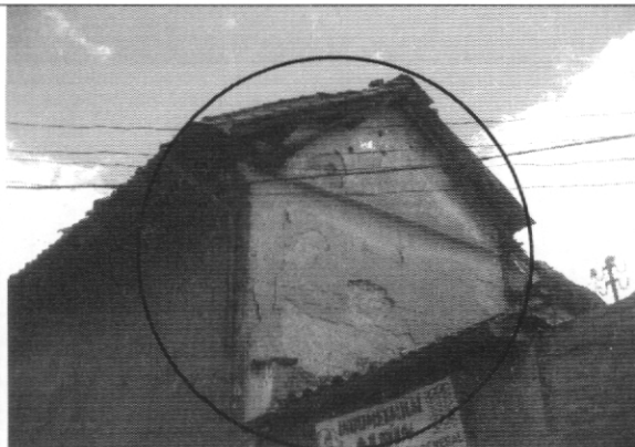
Foto 5. Desprendimiento de acabados, muro costado norte
