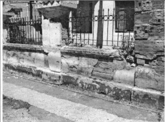
Foto 4. Daños en acabados del cerramiento del antejardín
