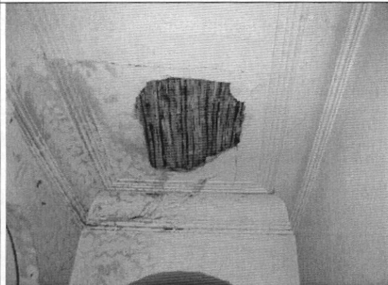
Foto 13. Daño en el cielo raso bajo cubierta
