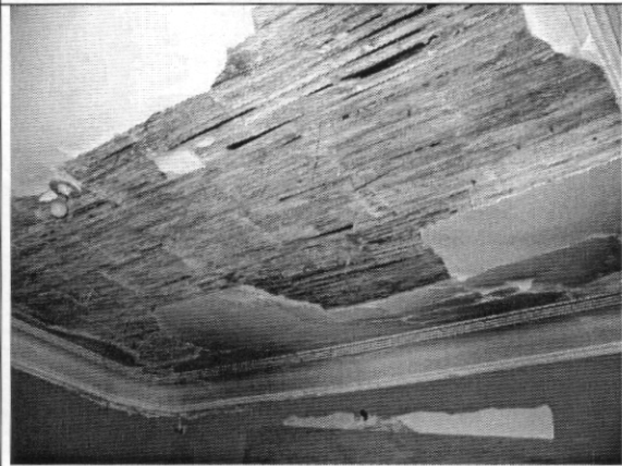
Foto 12. Colapsos parciales del cielo raso
