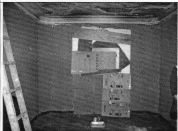
Foto 8. Muros de segundo piso con daño leve
