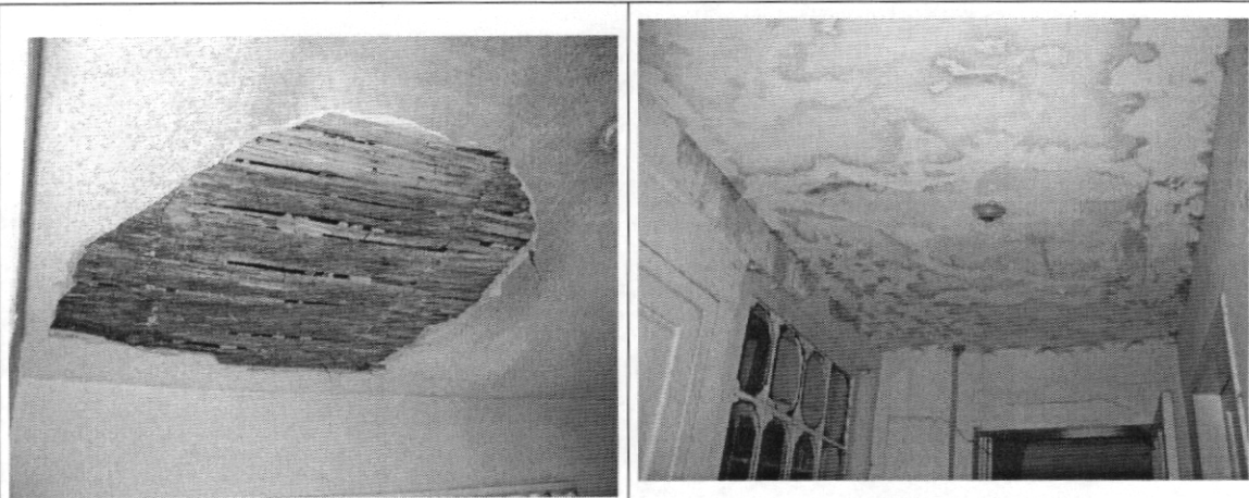
Foto 9. Humedad excesiva en cielo raso
