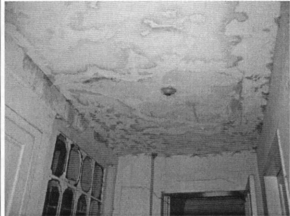
Foto 10. Alto deterioro en cielo raso
