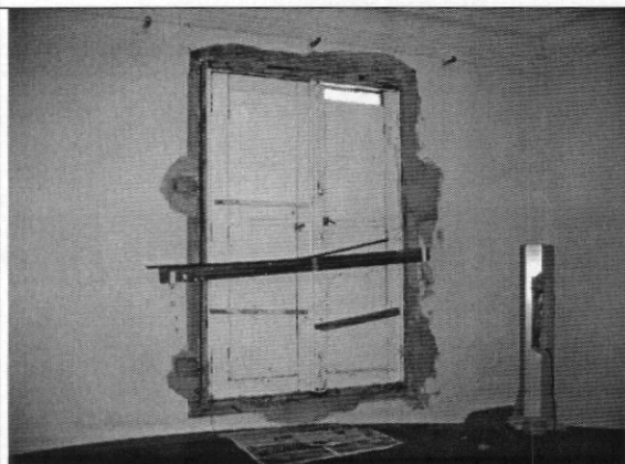
Foto 7. Afectación en el contorno de marcos de ventanas
