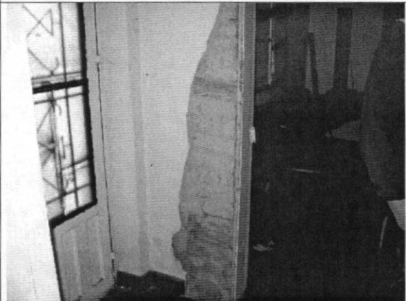
Foto 6. Desprendimiento de pañete en muros internos
