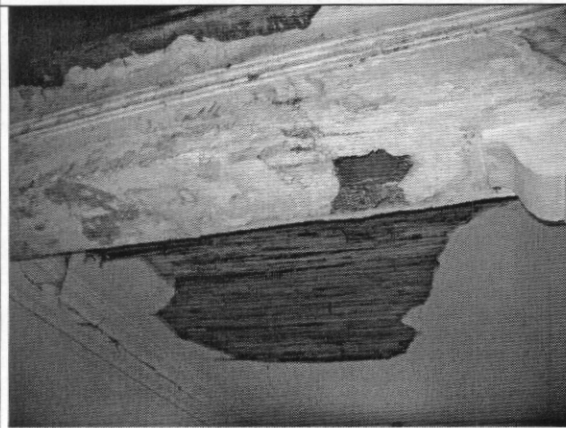
Foto 11. Afectación del cielo raso por humedad
