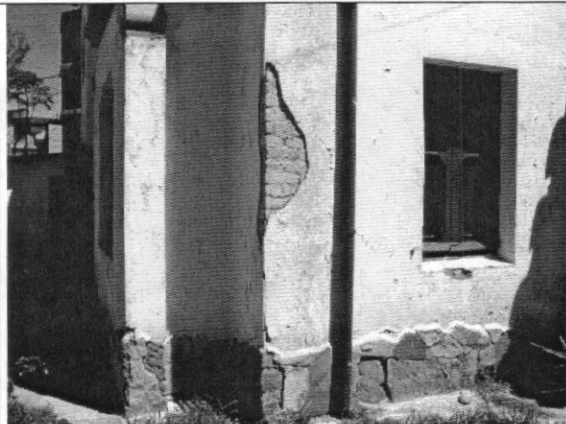
Foto 3. Desprendimiento de pañete de la fachada
