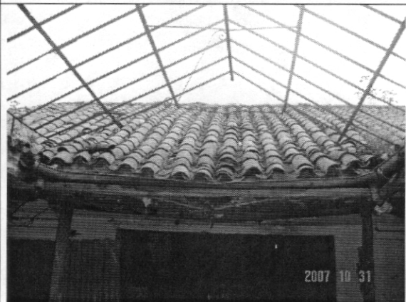
Foto 6. Deformaciones en vigas de madera
