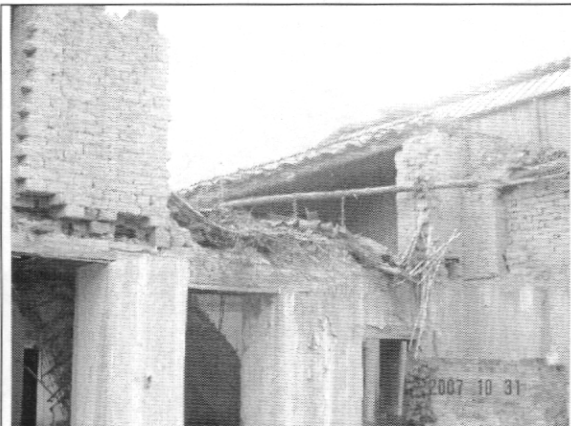
Foto 3. Colapsos parciales de muros
