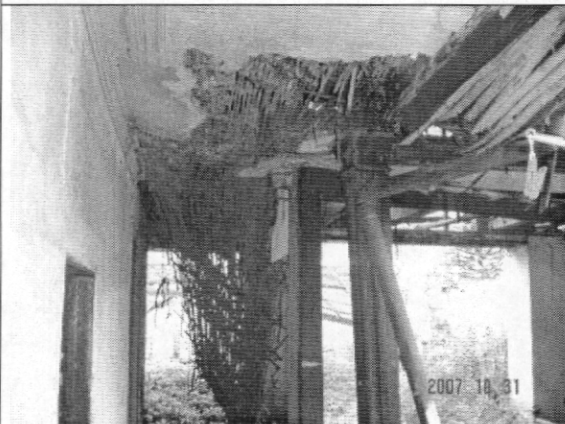
Foto 5. Pérdida de verticalidad de columnas de madera
