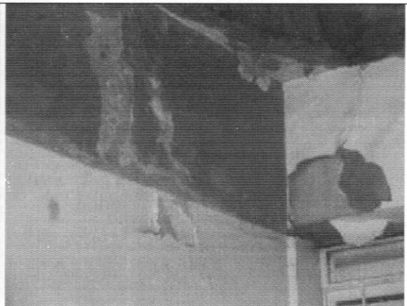
Foto 8. Deterioro en muros de segundo piso y daño en estructura
