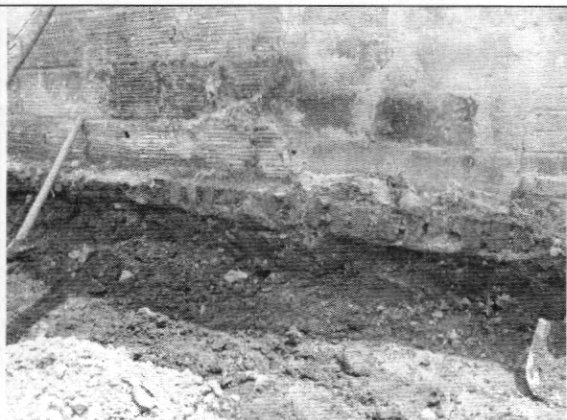
Foto 8. Tramo descubierto sin cimentación
