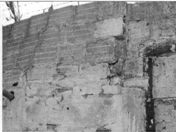
Foto 6. Tramos sin alineamiento horizontal
