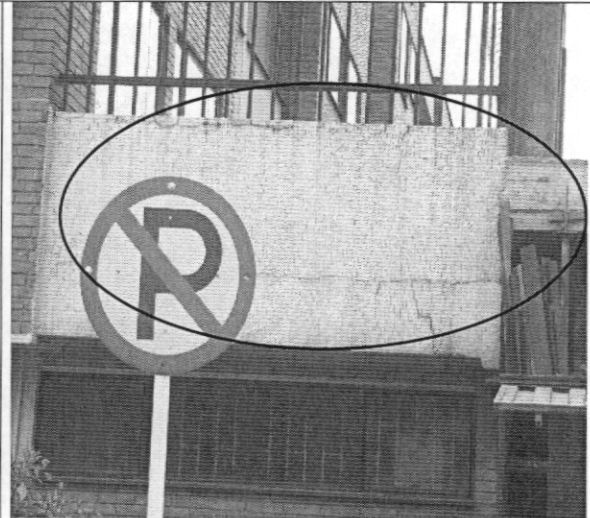
Foto 2. Fisuras en acabado antepecho costado norte
