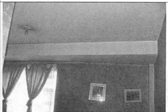
Foto 6. Muros apartamento tercer piso
