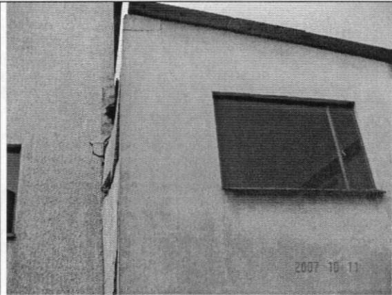
Foto 8. Desplazamiento rotacional hacia los predios vecinos
