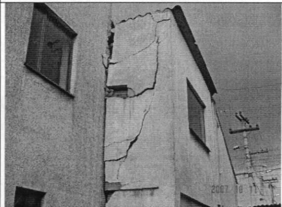
Foto 6. Fractura en muro externo de la zona de ampliación
