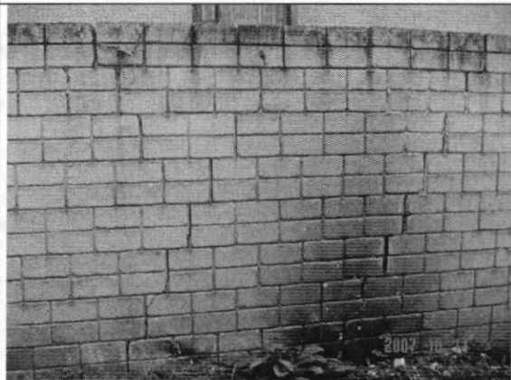
Foto 11. Agrietamientos en el muro de lindero lateral
