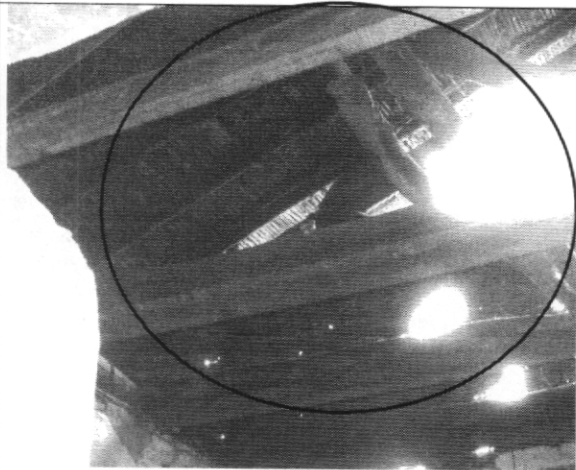
Foto 9. Estructura de madera de cubierta en mal estado
