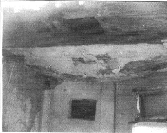
Foto 7. Colapso cielo raso costado oriental
