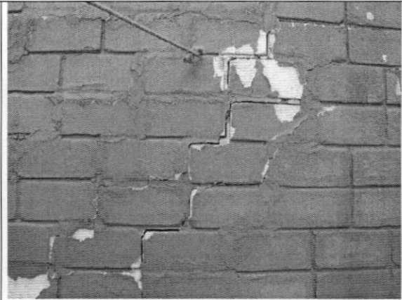
Foto 4. Agrietamiento del muro posterior de lindero
