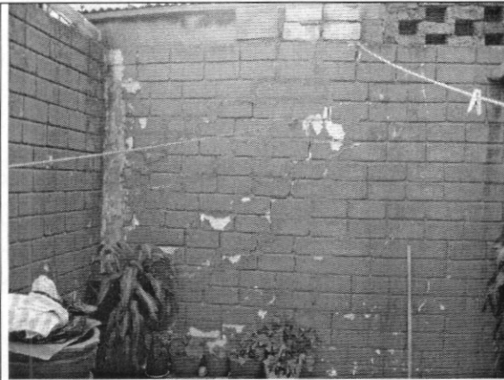
Foto 3. Muro posterior con pérdida de verticalidad
