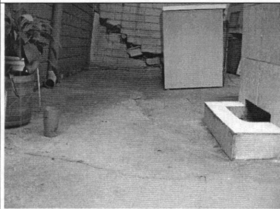
Foto 7. Fracturas y deformaciones en placa de piso
