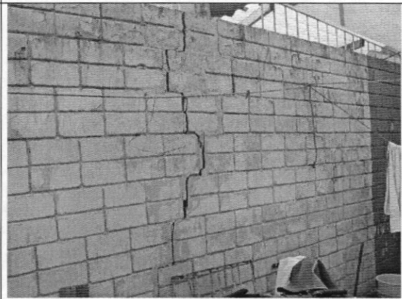
Foto 6. Fractura en muro lateral de lindero
