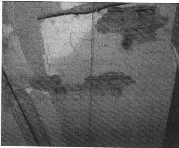
Foto 9. Deterioro en cielo raso de la zona frontal, segundo piso
