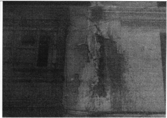
Foto 4. Deterioro en acabados fachada costado occidental, segundo piso
