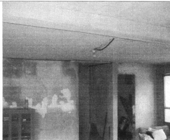
Foto 3. Humedad en muros del segundo piso
