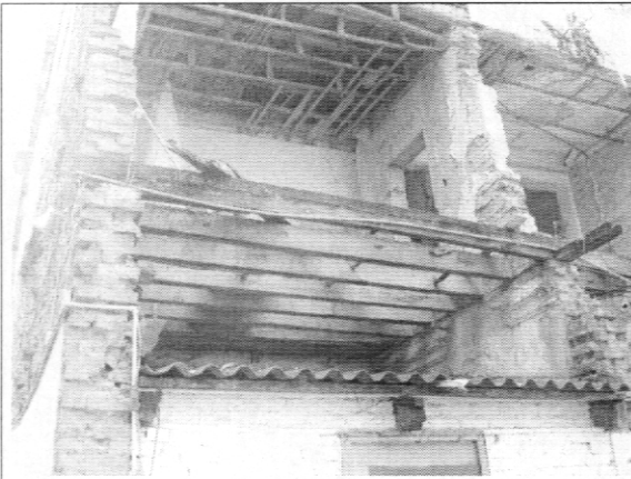
Foto 3. Daño fuerte de la estructura
