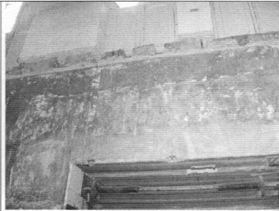
Foto 4. Falta del entrepiso de segundo nivel
